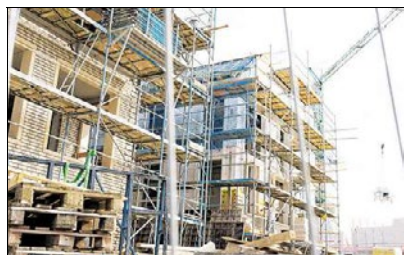
Mitten in Dangast wächst Stein um Stein der Nordseepark mit 700 neuen Gästebetten heran.
