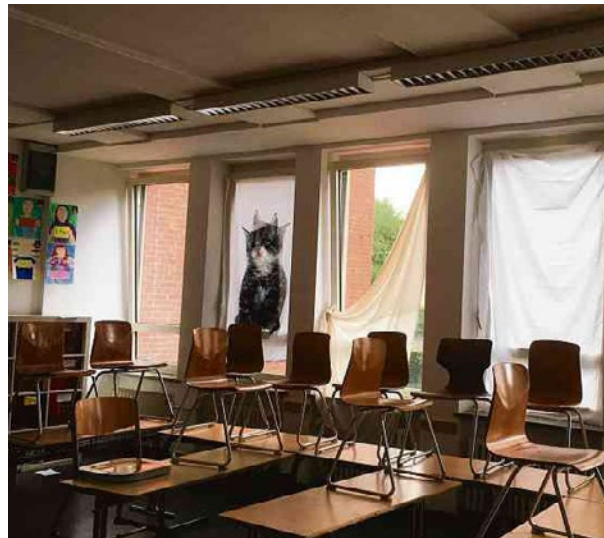
Bettlaken ersetzen die defekten Jalousien als Sonnenschutz.
