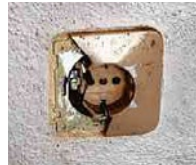
Viele Steckdosen befinden sich in einem desolaten Zustand.
