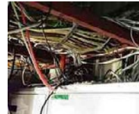
In der Aula herrscht ein Wirrwarr an Kabeln.
