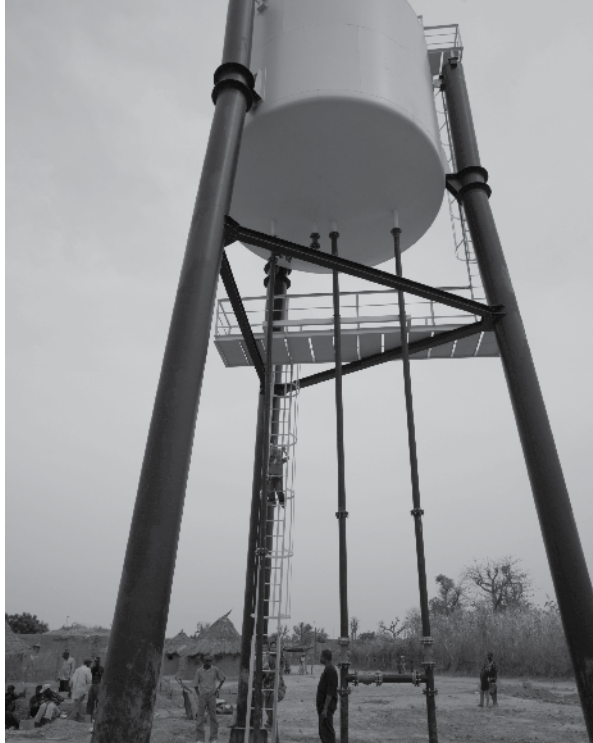
Tiefbrunnen in Mali mit einer mit Solarenergie betriebenen Pumpe. Erneuerbare Energien können für Entwicklungsländer eine wichtige wirtschaftliche Stütze sein.
